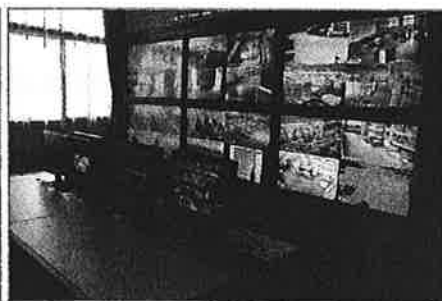
冷凍食品工場の監視カメラ集中管理室
